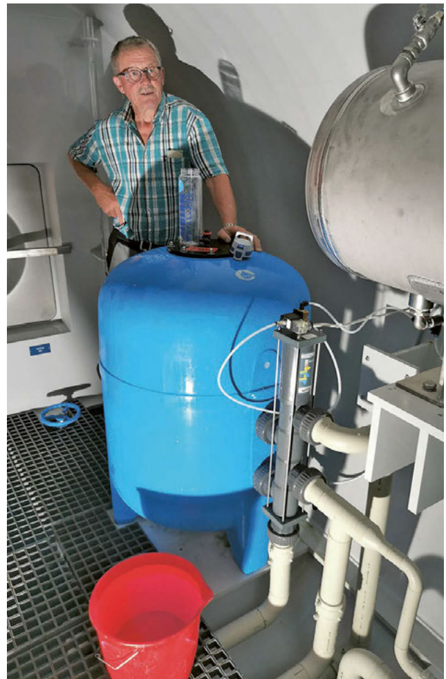
Unser ehemaliger Alpmeister und Geburtshelfer der Wasserversorgung «Gamperfin Stichböden», Peter Tobler, im Rohrkeller des dortigen Tanks.
