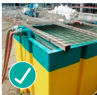
Absetzbecken mit Gitterrost, Einleitung vor der Prallwand/Tauchwand
