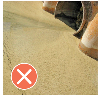
Schlammraum ist überfüllt, Leerung notwendig
